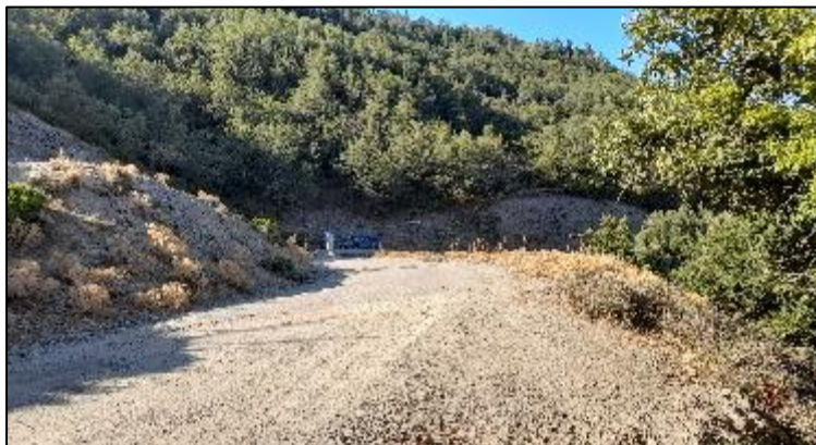
Fig. 7 _ Stato di fatto sovrastruttura stradale _ assenza barriere laterali
